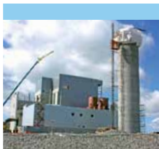
Kraftvärmeverket – med en 80 meter hög skorsten och en ackumulatortank för 22 miljoner liter vatten – är en investering på 750 miljoner kronor. Panneffekten blir 42 MW, varav 30 MW värme.
